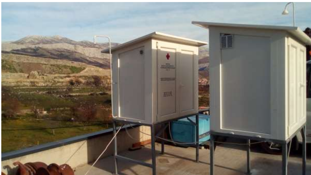
Slika 4. Automatska mjerna stanica „Karepovac“
