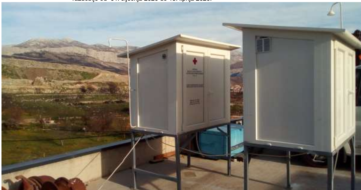
Slika 4. Automatska mjerna stanica „Karepovac“
