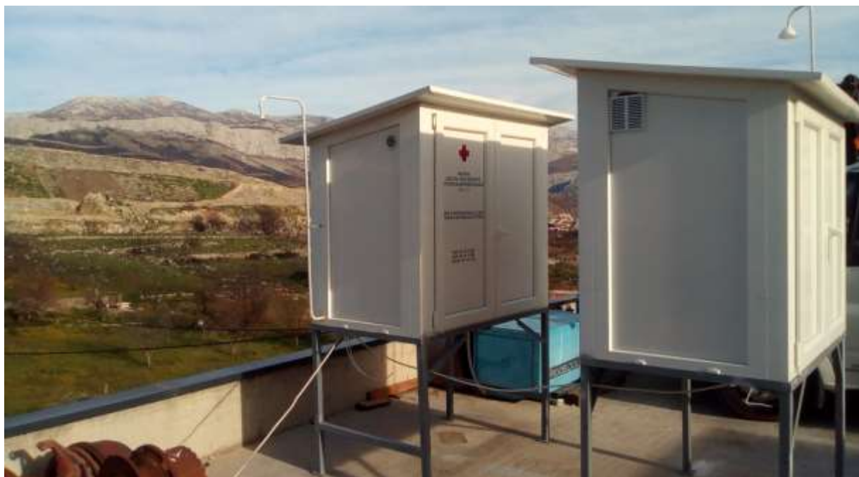
Slika 1. Automatska mjerna stanica „Karepovac“
